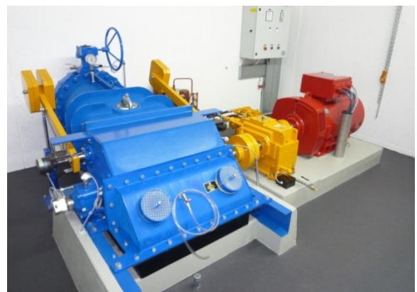
Ossberger Turbine mit Zwischengetriebe und Generator
